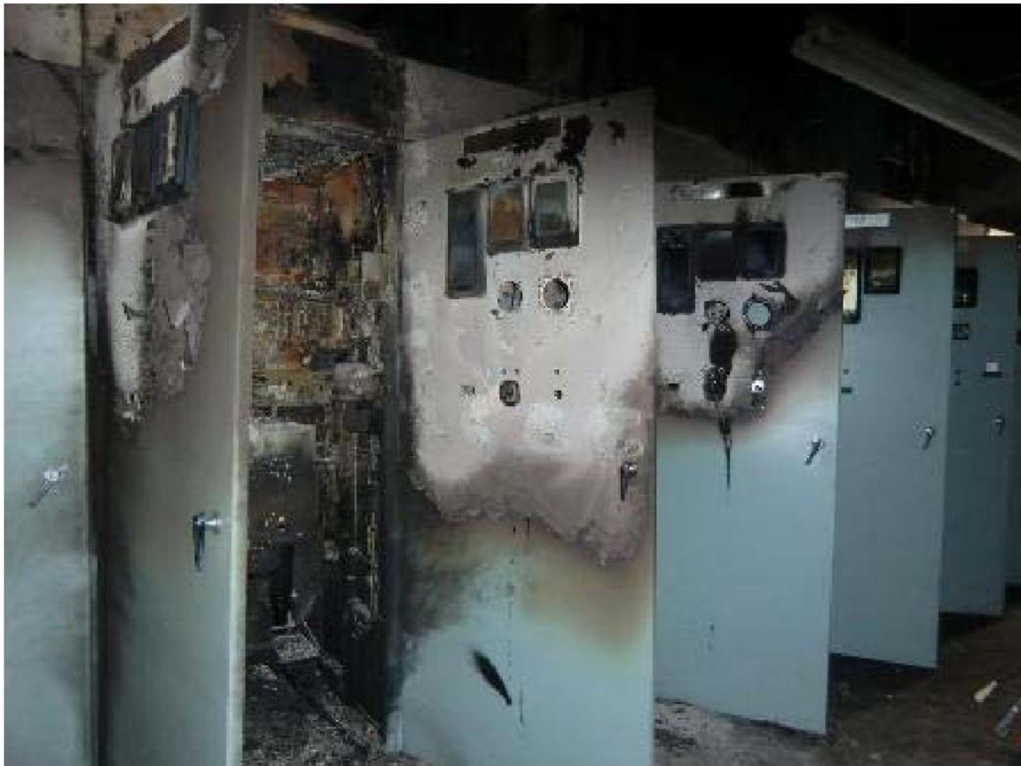
高压电源盘 現場写真
