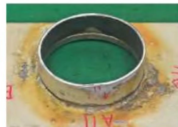
上部配管接続部損傷箇所 (上部切除前)
