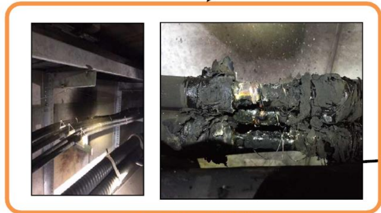
＜洞道内ケーブル損傷箇所＞
